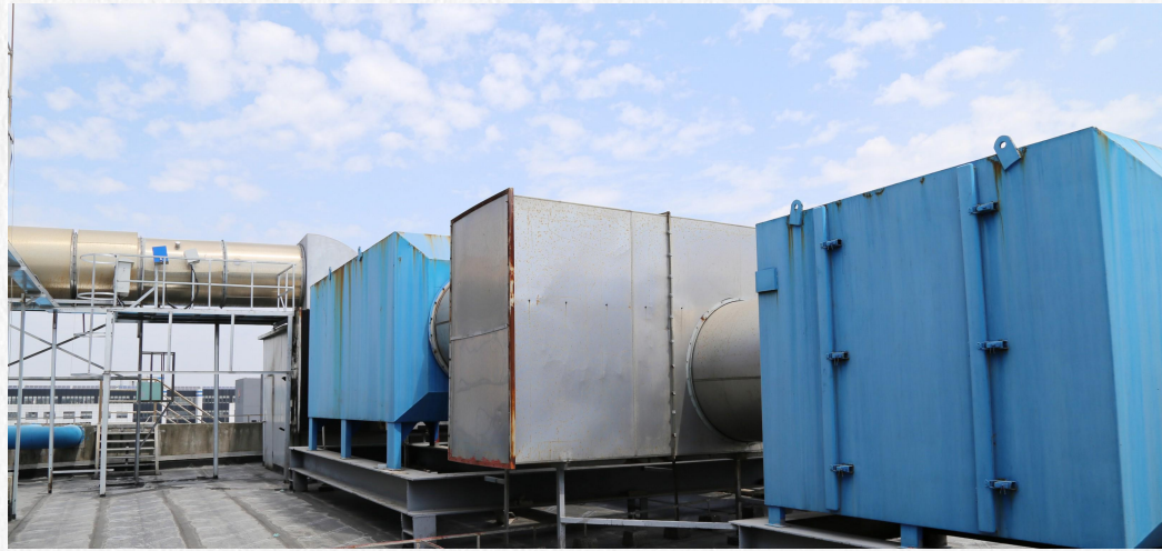
楼顶安装VOCs活性炭吸附装置和排放管
