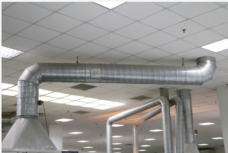
调墨、印刷、上光机台上方都设置了吸风口，对废气进行收集排放
